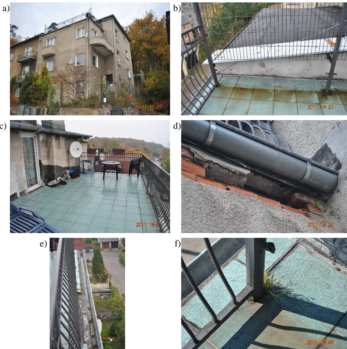
Rys. 1. Wielorodzinny budynek mieszkalny stanowiący przedmiot artykułu: a) elewacja frontowa, b) widok połaci dachowej na sąsiednim budynku z nie przebudowanym stropodachem c) widok tarasu powstałego w wyniku samowolnie prowadzonych prac budowlanych, d) uszkodzenia w miejscu oparcia żelbetowej płyty tarasu na murach zewnętrznych, e) uszkodzenia gzymsu, f) sposób montażu balustrady ochronnej
