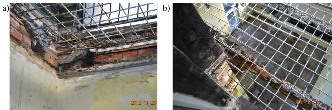
Rys. 2. Strop nad II piętrzem wielorodzinnego budynku mieszkalnego stanowiącego przedmiot artykułu czasie prac remontowych: a) uszkodzenia ścian w narożniku, widoczne gniazda oparcia belek na murze oraz styropian pod żelbetową płytą stropową b) uszkodzona drewniana belka stropowa przy kominie, widoczny szcegół zbrojenia płyty żelbetowej
